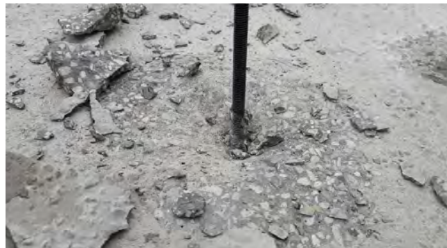
Figura 15. Falla por arrancamiento del concreto sin extracción de anclaje \phi 1/2'' a profundidad de embebido igual a 2,5 veces el diámetro.
